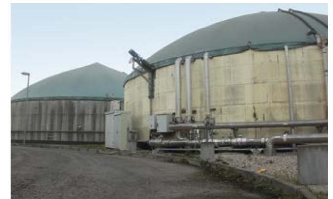
Die Biogasanlage benötigt pro Jahr rund 35.000 Tonnen Mais- und 7.000 Tonnen Grassilage um täglich etwa 22.000 Kubikmeter Rohgas zu erzeugen.
