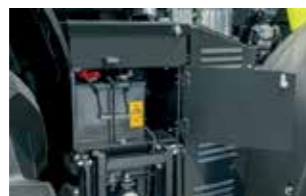
La batterie est commodément placée au-dessus de l'échelle d'accès droite.
