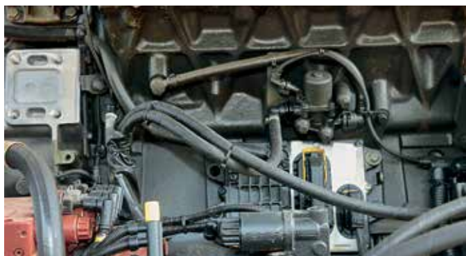
Damit das AdBlue bei geringen Temperaturen nicht gefriert, wird der AdBlue-Tank durch das Motorkühlwasser geheizt.
